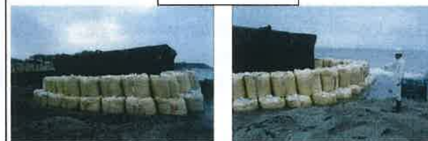
②仮締切(大型土のう工)崩壊状況
