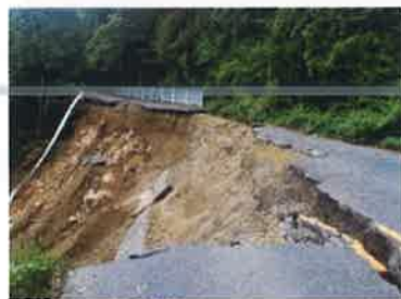
主要地方道 谷山知覧線（鹿児島県鹿児島市） 道路崩壊
