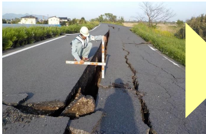
△大きな亀裂が走った堤防の被災状況調査
