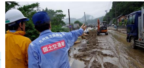
▲ 道路の被災調査
